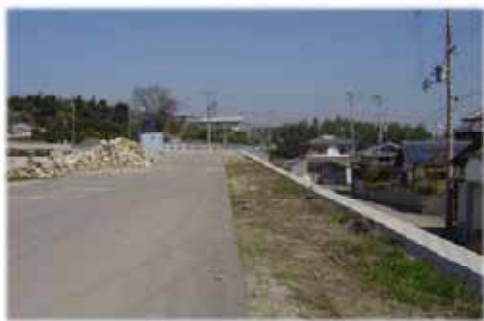
進展しない取り付け道路工事状況
